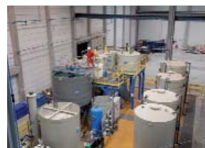
9. Station de filtrage et retraitement chimique des eaux
